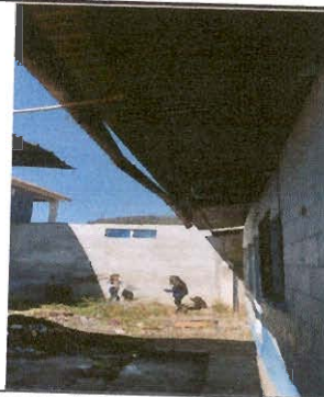
Foto 4: canales en mal estado
