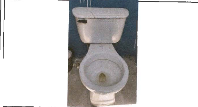
Foto 1: Sanitario en mal estado
