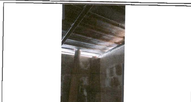
Foto 2: Laminas en mal estado de la cocina
