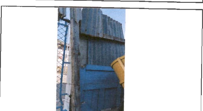
Foto 4: cambiar laminas en mal estado por una puerta
